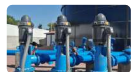
Sistemas de Bombeo
